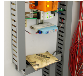
ActivPak® de ZERUST® protege controles caros en un panel ubicado en una planta de tratamiento de aguas residuales.
